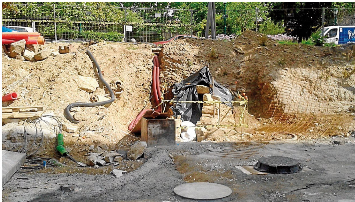
En el centro, y cubierta con un plástico, la antigua conducción de fecales destapada en Carreira do Conde. Foto: D. A.
